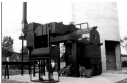
Exemple typique de chaufferie
